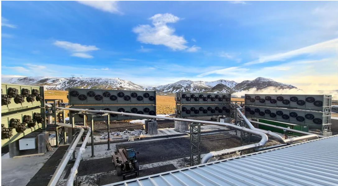
Foto de los colectores de CO 2 de Climateworks en las instalaciones Orca, Reykjavík, Islandia.
